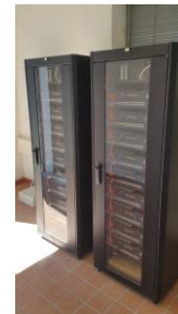
Batterie ioni di litio Pn=43 kwh lato CC
